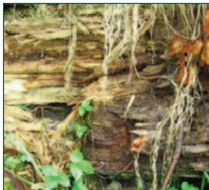
Pourriture fibreuse sur traverse d'épicéa après 10 ans d'utilisation d'un ouvrage non drainé en zone très humide
