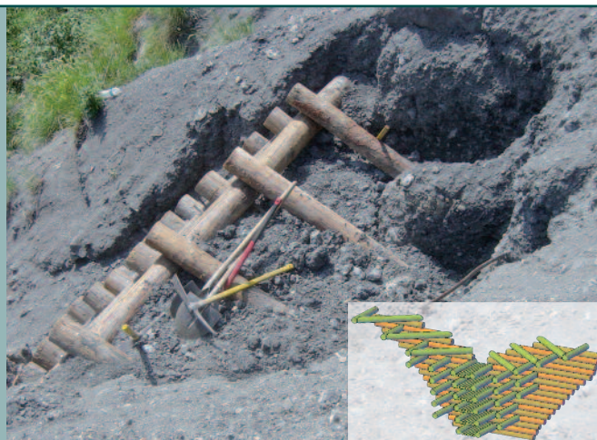
Soutènements de versant en FD de Crots : schéma et construction d'un ouvrage simple paroi. Les tirants (en vert) sont ancrés dans le remblai, la forme en V laisse écouler les eaux de ruissellement
