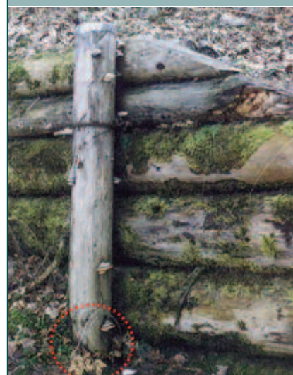
Protection de tête de pieu par une couverture métallique ; la zone de contact entre le pieu et le sol n'en reste pas moins vulnérable aux attaques biologiques par les champignons
