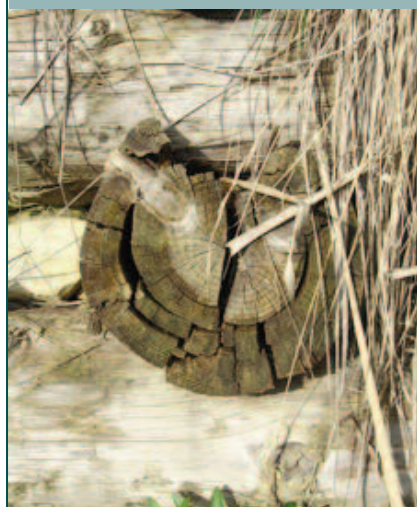
Dégradation rapide (en 5 ans) de traverse en mélèze par des pourriture cubiques au niveau d'un assemblage faisant piège à eau du fait notamment de l'exposition
